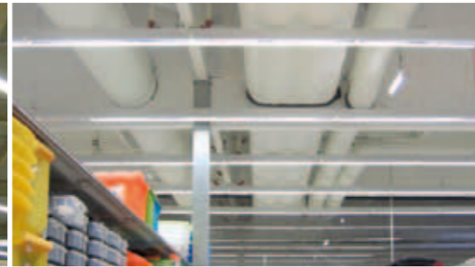
Récupération de chaleur
