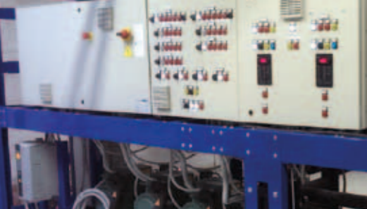
Production de froid (CO 2 transcritique, fluides frigoporteurs...)
