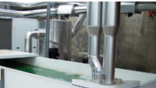
Bac de décantation d'une ligne de refroidissement
