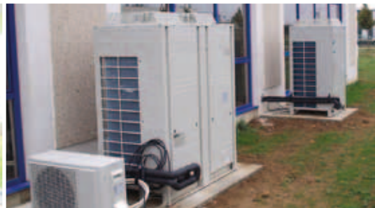
Groupes de condensation extérieurs
